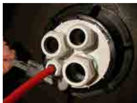
5. Potrubí/kabel protáhnout prostupovým šroubením a svěrnou maticí zajistit pozici potrubí v prostupu.
