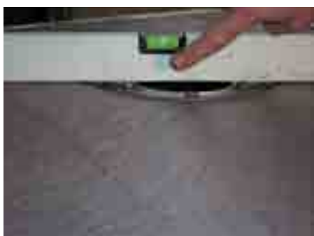
10. Bezproblémová pokládka dlažby je možná: celá izolační souprava leží pod úrovní betonové mazaniny
