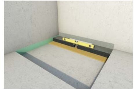
3. Duschrinne in den Klebermörtel und an die Wand setzen und waagrecht einnivellieren
