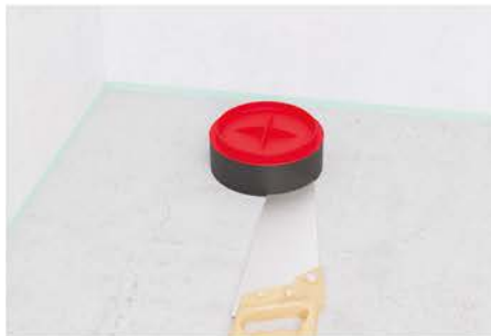
8. Nach dem Aushärten des Estrichs den herausstehenden Rohrstützen estrichbündig mit einer Säge abschneiden.
