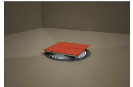
9. Aufsatzrahmen mit Bauschutz in den Ablauf einsetzen, falls notwendig zur Höhenanpassung an die Fliesen abschneiden.
