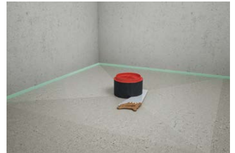
6. Nach dem Aushärten des Estrichs den herausstehenden Rohrstuben estrichbündig mit einer Säge abschneiden.
