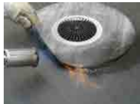
3. Az első bitumenréteget a födémhez olvasztjuk, majd a lefolyó bitumen szigetelőgallérját erre a rétegre melegítjük.
