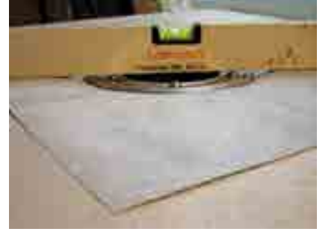
6. İzolasyon takımı şap seviyesinin altında kalıyor
